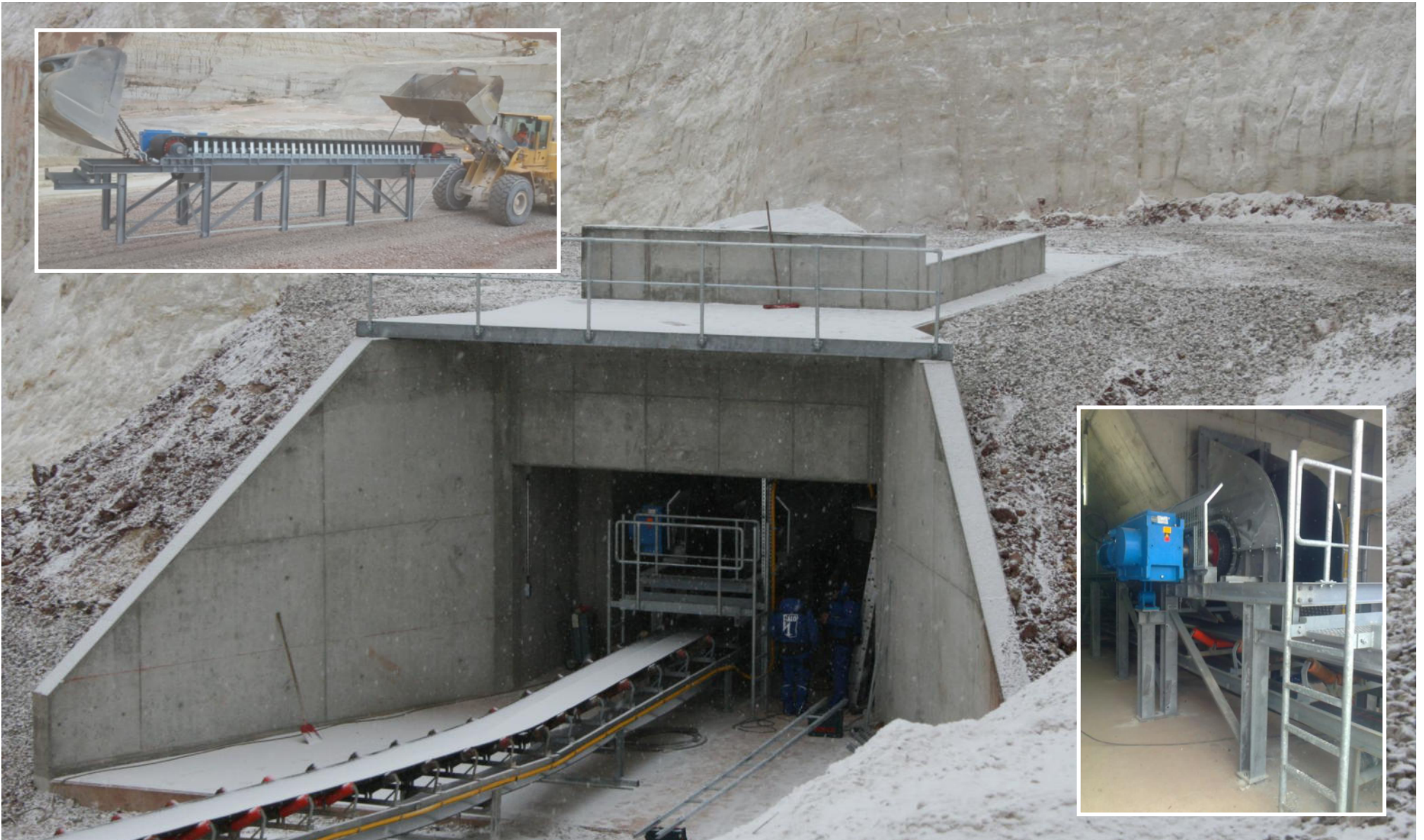
Austragskastenbeschicker unter Betontrichter, 2016
